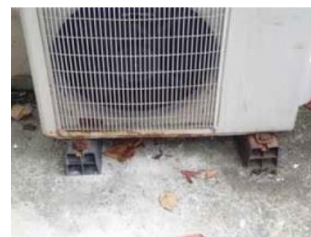
設備架台の鋼部材の腐食
