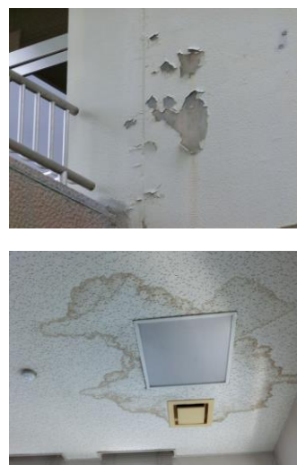
図 5-1 施設の劣化状況の例 (上：外壁塗装の剥離、下：天井の漏水)
