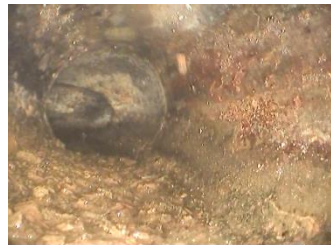
管底部が腐食した雑排水管 (配管用炭素鋼鋼管)
