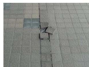
損傷した外構タイル
