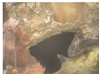
管内に異物が付着した雨水管 (配管用炭素鋼鋼管)
