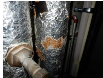
保温材の腐食箇所
