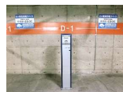
【電気自動車充電設備】
