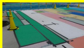
プールサイド材 不具合の放置
