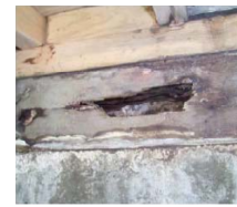
基礎や土台、はりに蟻害が発生し欠損している
