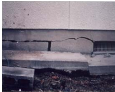
基礎の沈下や基礎が大きく破損している
