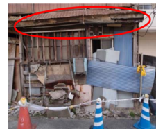
軒に不陸、剥離が生じている
