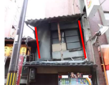
2 階部分が沈み込み全体的に傾斜している
