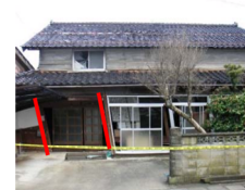
1 階部分が傾斜している
