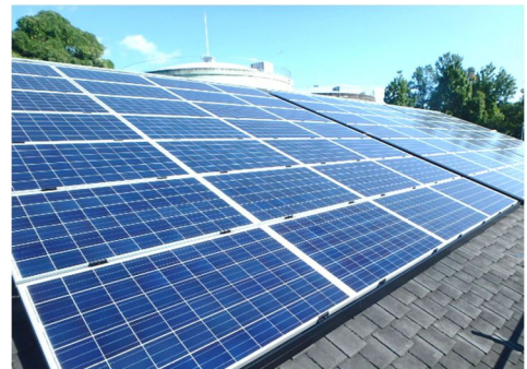
西穂積配水場の太陽光パネル
