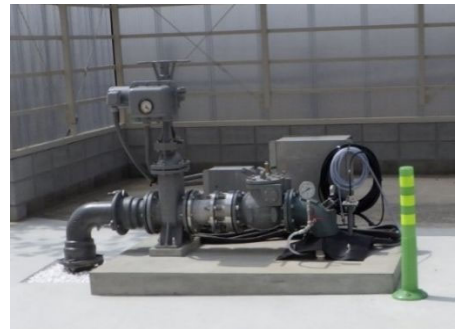
十日市浄水場 深井戸1号井
