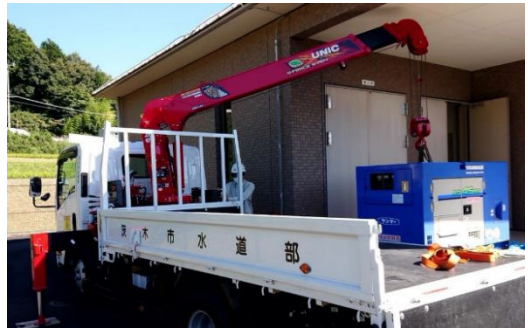
可搬式発電機
