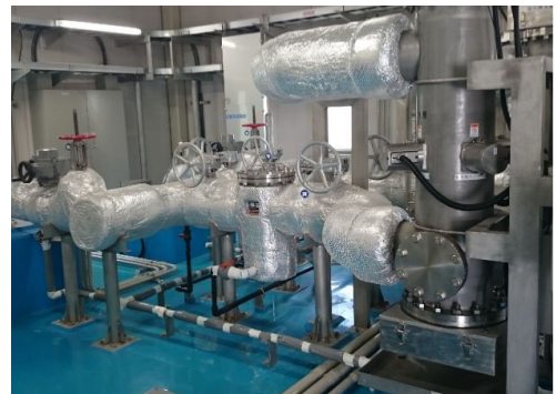
紫外線照射設備（十日市浄水場）
