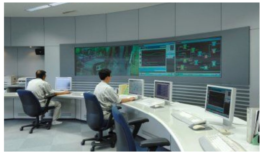
十日市浄水場中央監視室
