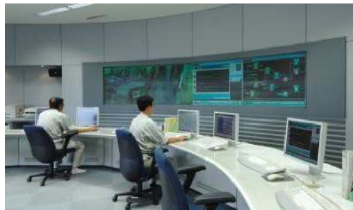
十日市浄水場中央監視室
