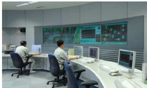
十日市浄水場中央監視室
