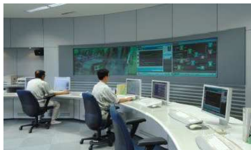
十日市浄水場中央監視室
