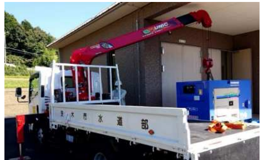
可搬式発電機
