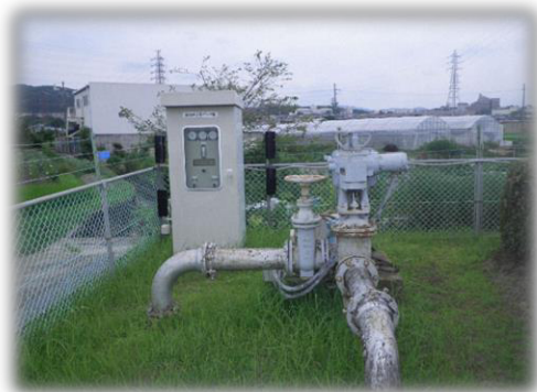
十日市浄水場 第3号取水井
