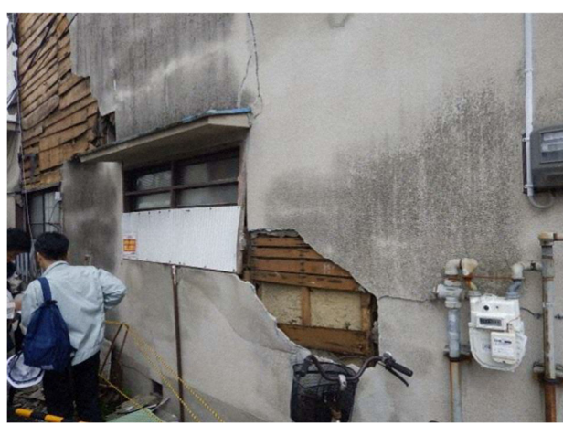
▲住家壁の剥落被害
