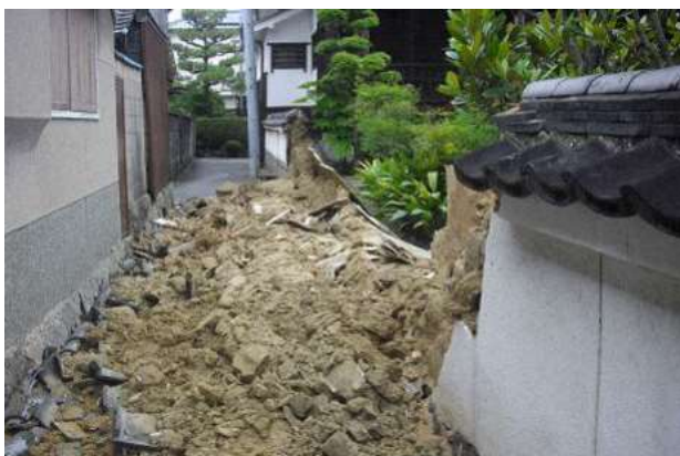
▲道路沿いの土塀の崩壊
