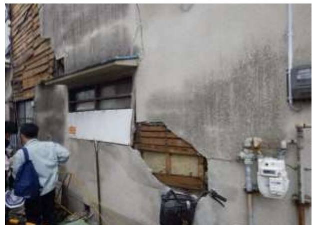
▲住家壁の剥落被害
