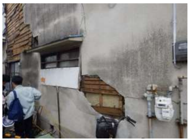
▲住家壁の剥落被害
