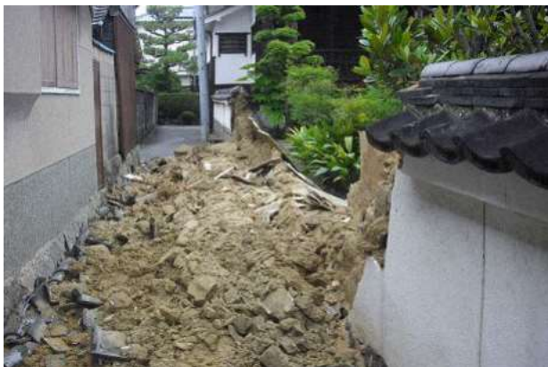
▲道路沿いの土塀の崩壊
