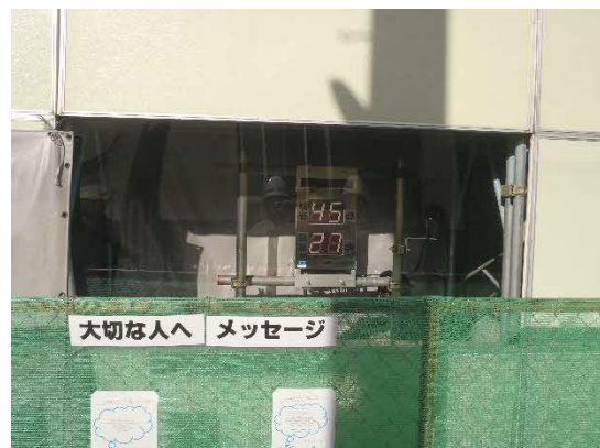
外部 南面 1 階 騒音振動計設置状況
