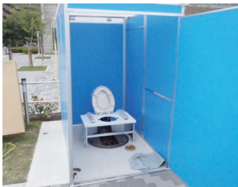
マンホールトイレの設置例
