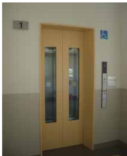
水尾小学校に設置されているエレベーター
