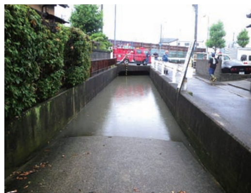
野々宮二丁目付近の冠水した地下道
