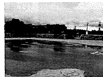
桑田公園の漏水現場
