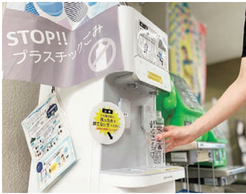
マイボトル専用純水サーバー（市役所本館1階北側）
