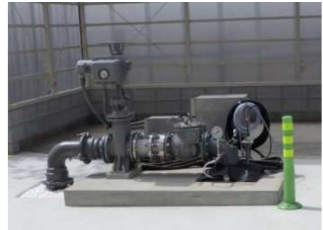
十日市浄水場 深井戸1号井
