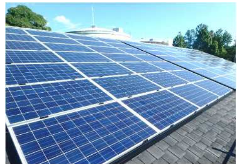
西穂積配水場の太陽光パネル
