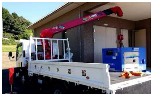
可搬式発電機
