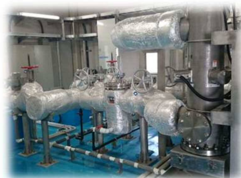
紫外線照射設備（十日市浄水場）
