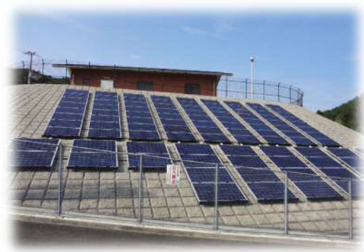
やまぶき高区配水池
