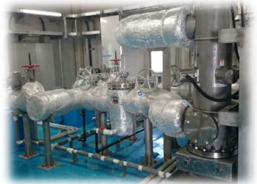
紫外線照射設備（十日市浄水場）
