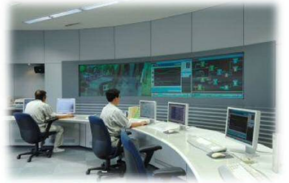
十日市浄水場中央監視室
