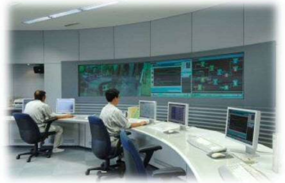
十日市浄水場中央監視室
