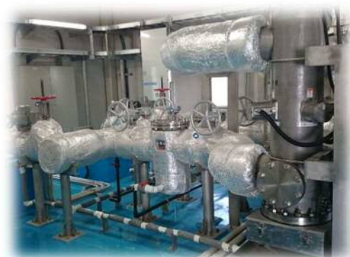
紫外線照射設備（十日市浄水場）
