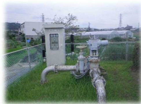
十日市浄水場 第3号取水井
