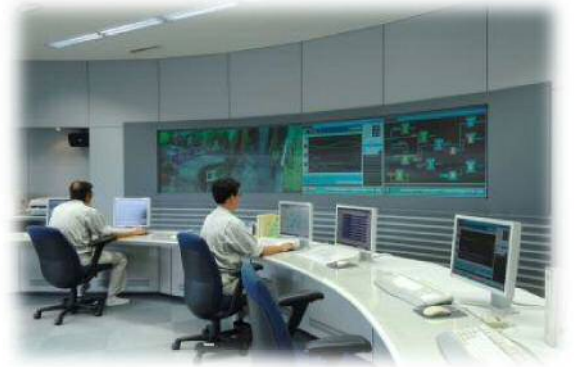
十日市浄水場中央監視室
