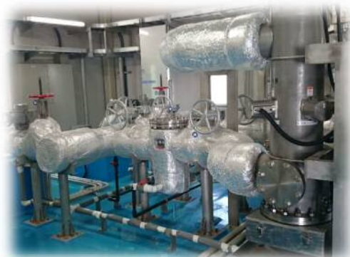
紫外線照射設備（十日市浄水場）
