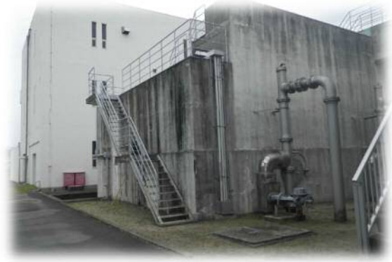
急速ろ過池（十日市浄水場）
