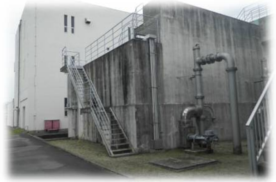
急速ろ過池（十日市浄水場）
