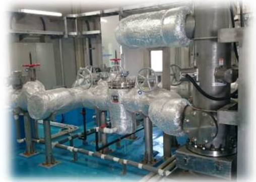
紫外線照射設備（十日市浄水場）
