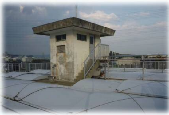
凝集沈殿池（十日市浄水場）
