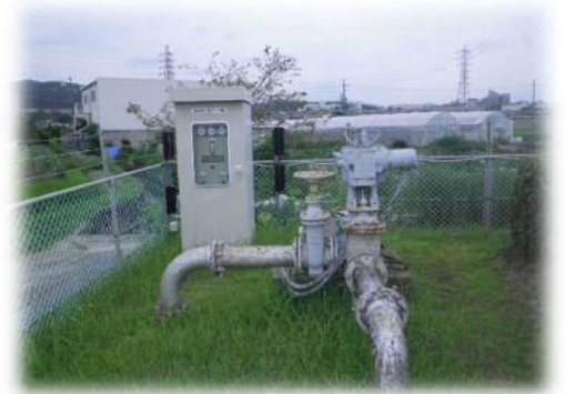
十日市浄水場 第3号取水井
