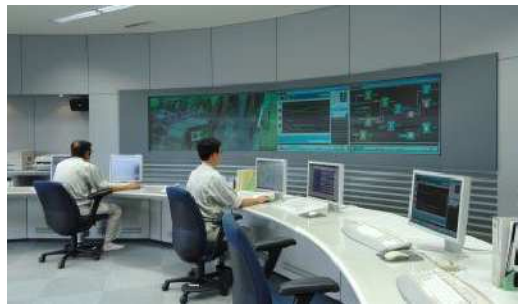
十日市浄水場中央監視室
