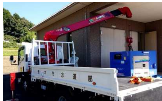
可搬式発電機
