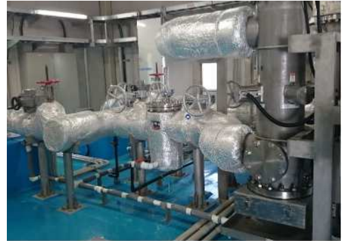
紫外線照射設備（十日市浄水場）
