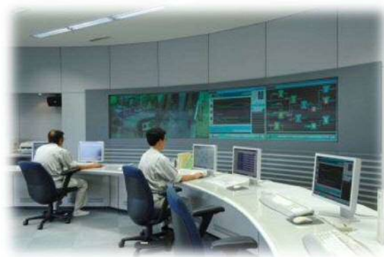
十日市浄水場中央監視室
