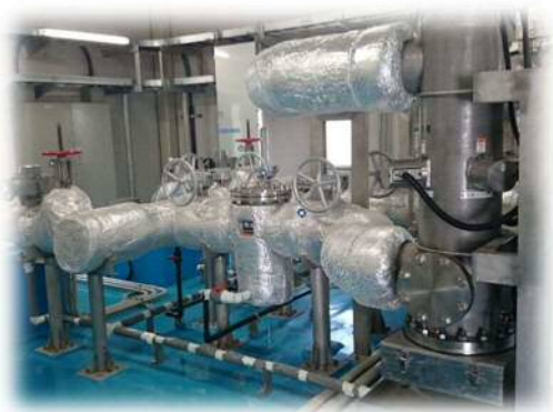
紫外線照射設備（十日市浄水場）
