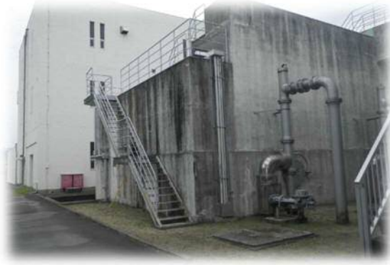
急速ろ過池（十日市浄水場）
