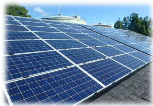
西穂積配水場
