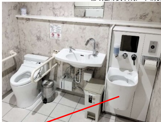
オストメイト対応水洗器具を設置
