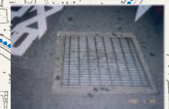
グレーチングの目が粗い。
