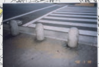
誘導用ブロックが未整備である。
