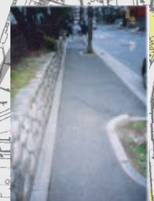
歩道舗装劣化による凹凸、植栽ますの浮きがある。
