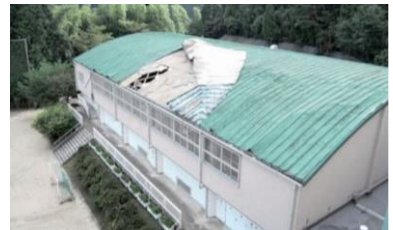
台風第21号における被災状況
