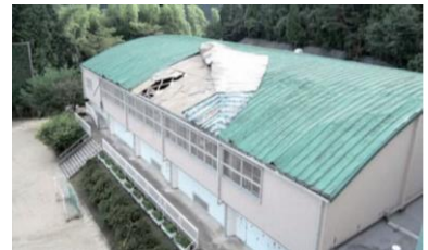
台風第21号における被災状況
