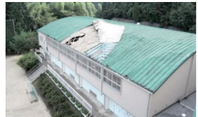
台風第21号における被災状況
