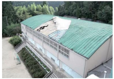
台風21号おける被災状況
