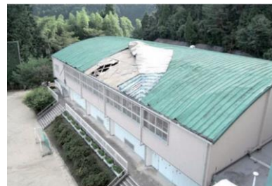
台風21号おける被災状況
