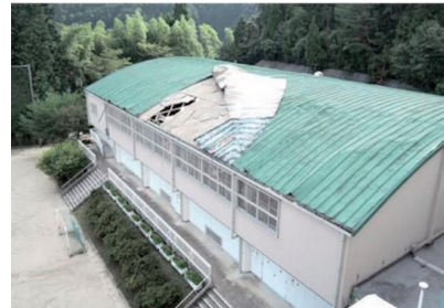
台風 21 号における被災状況
