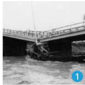
千歳橋の橋脚破損(茨木市戸伏町)
