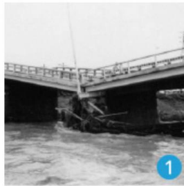
千歳橋の橋脚破損(茨木市戸伏町)
