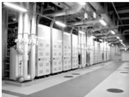
中之島三丁目熱供給センター
