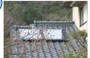
太陽熱利用システム
