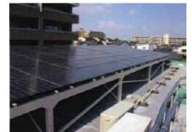
市内民間保育園に導入された太陽光発電
