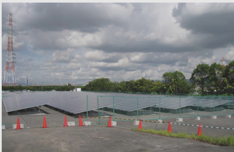
市所有の土地を民間事業者に貸し出し設置した 太陽光発電システム 【環境衛生センター最終処分場】
