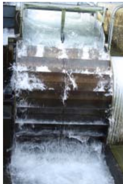
マイクロ水力発電(山梨県都留市)
