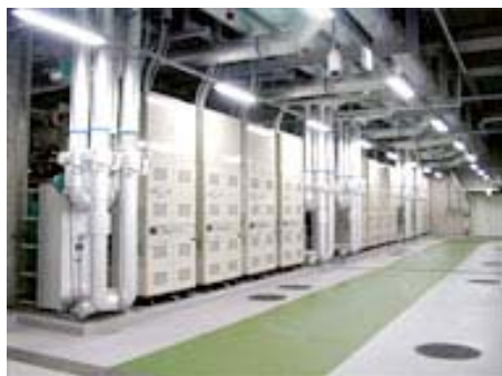
中之島三丁目熱供給センター
