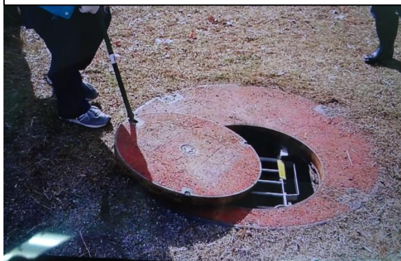
耐震性貯水槽の蓋をあけている様子
