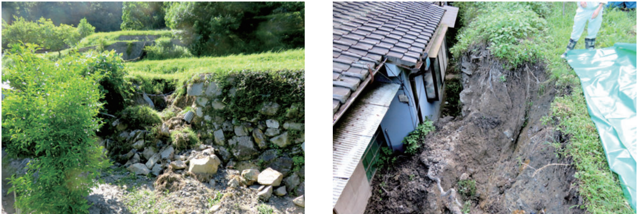
図表 粟生岩阪地区の被害
