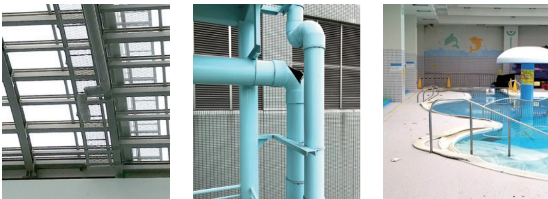
図表 西河原市民プールの被害
