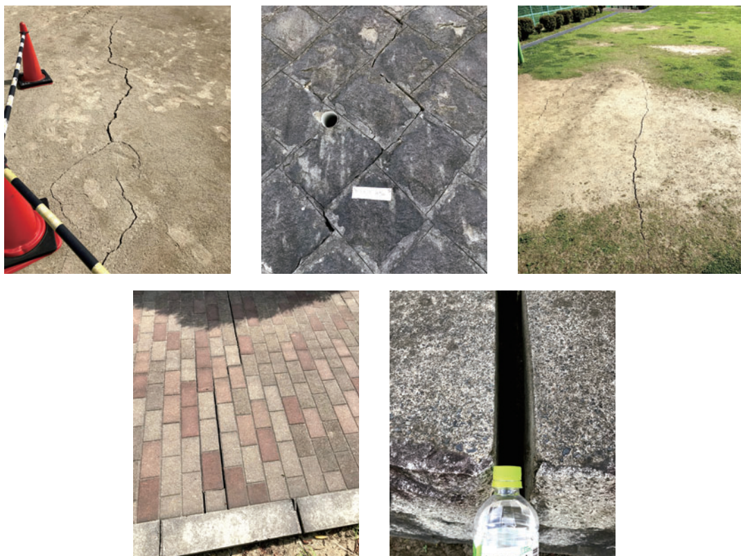
図表 桑原運動広場の被害
