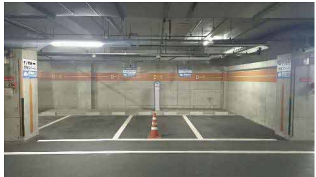
写真 中央公園駐車場 EV 車用充電スタンド
