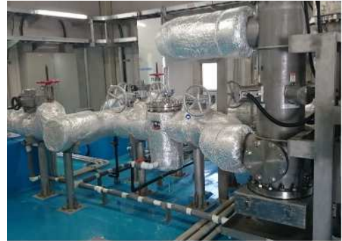
紫外線照射設備（十日市浄水場）
