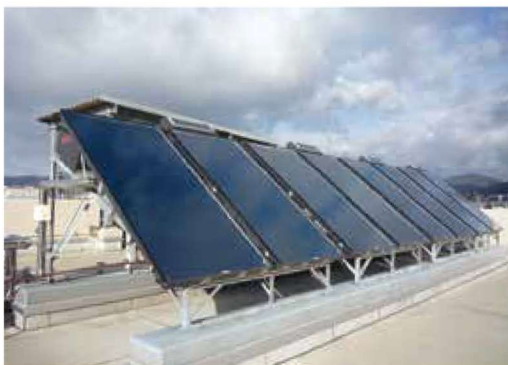
消防署西河原分署に設置した太陽熱温水器
