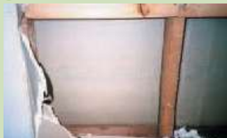
砒素・カドミ含有石膏ボード
