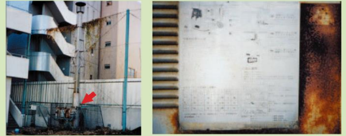
廃棄物焼却炉
