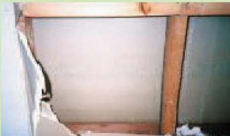
砒素・カドミウム含有石膏ボード
