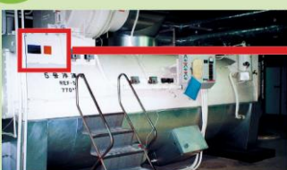
ターボ冷凍機
