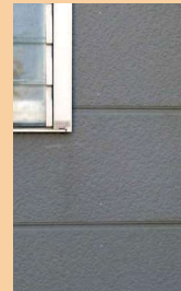
石棉板（窯業系サイディング）
