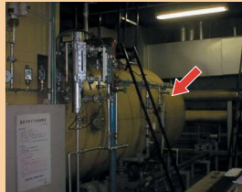
石綿含有保温材（ボイラ外周部）
