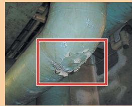
石綿含有保温材（配管曲がり部）
